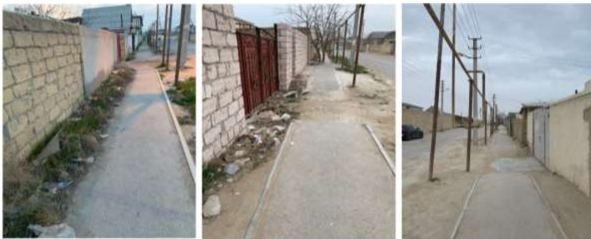
Рис. 15. Аварийное состояние тротуаров на улицах села
